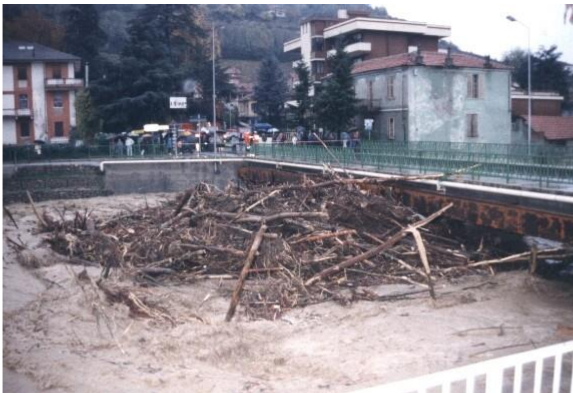
Foto n° 3: materiale accatastato contro la pila in alveo del vecchio ponte sul torrente Belbo, a Santo Stefano Belbo (CN), durante la piena del 1994
