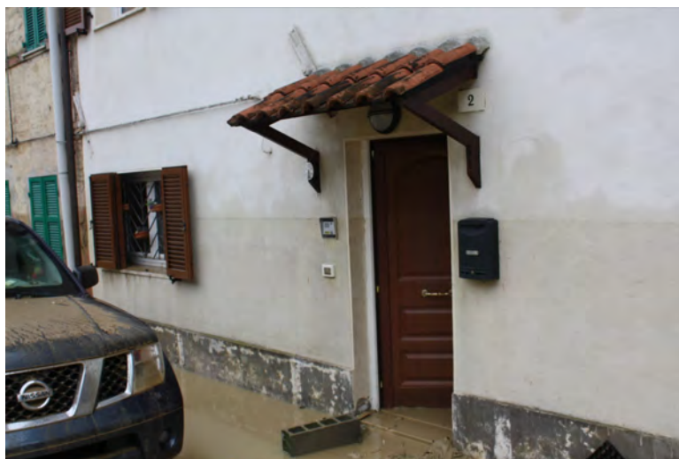
Figura 51: Senigallia - Borgo Bicchia - Sul muro è evidente il segno del livello raggiunto dall'acqua in corrispondenza delle abitazioni.
