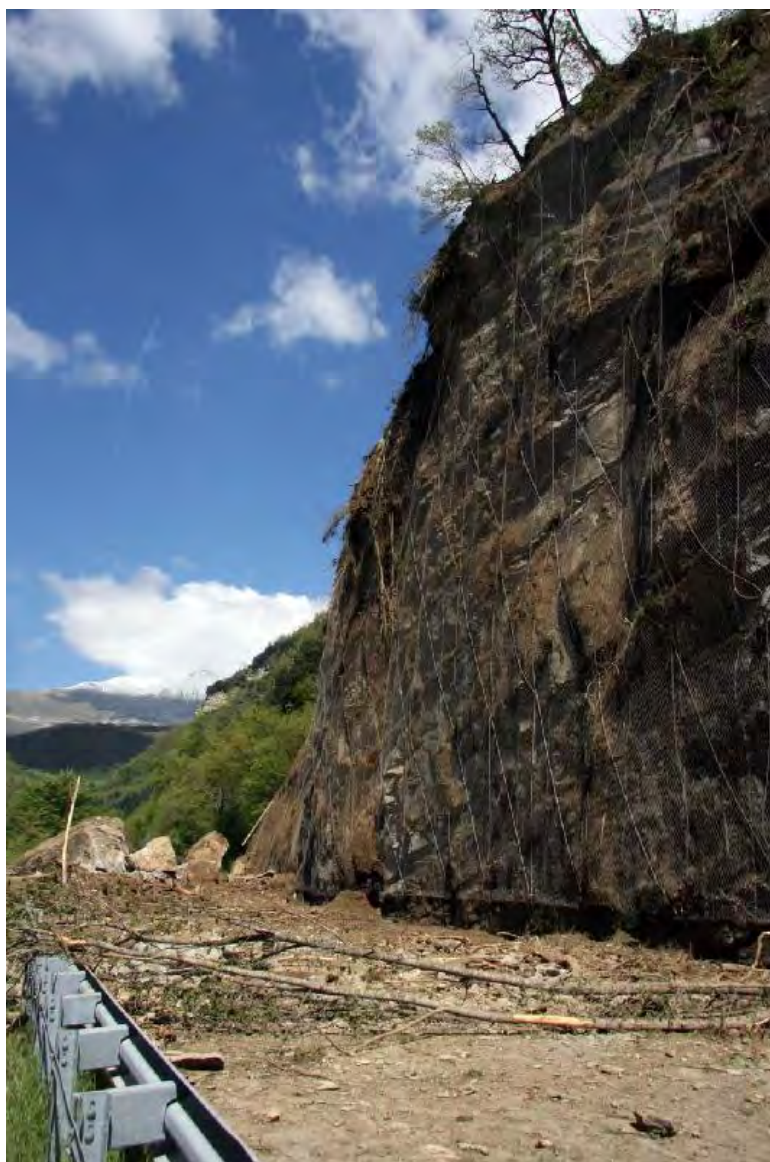
Figura 103: Frana sulla SS Salaria a Trisungo, Arquata del Tronto - Fonte Il Resto del Carlino.
