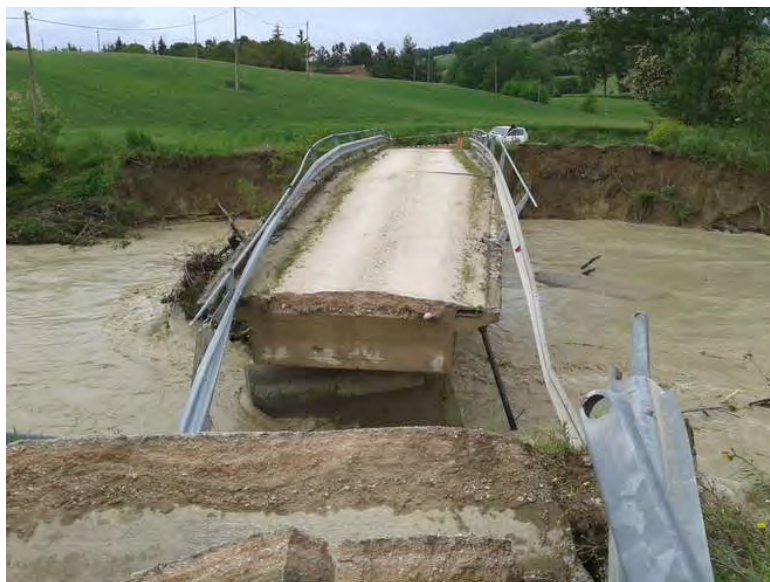
Figura 101: Ponte crollato sul fiume Ete Morto - Fonte Corriere Adriatico.
