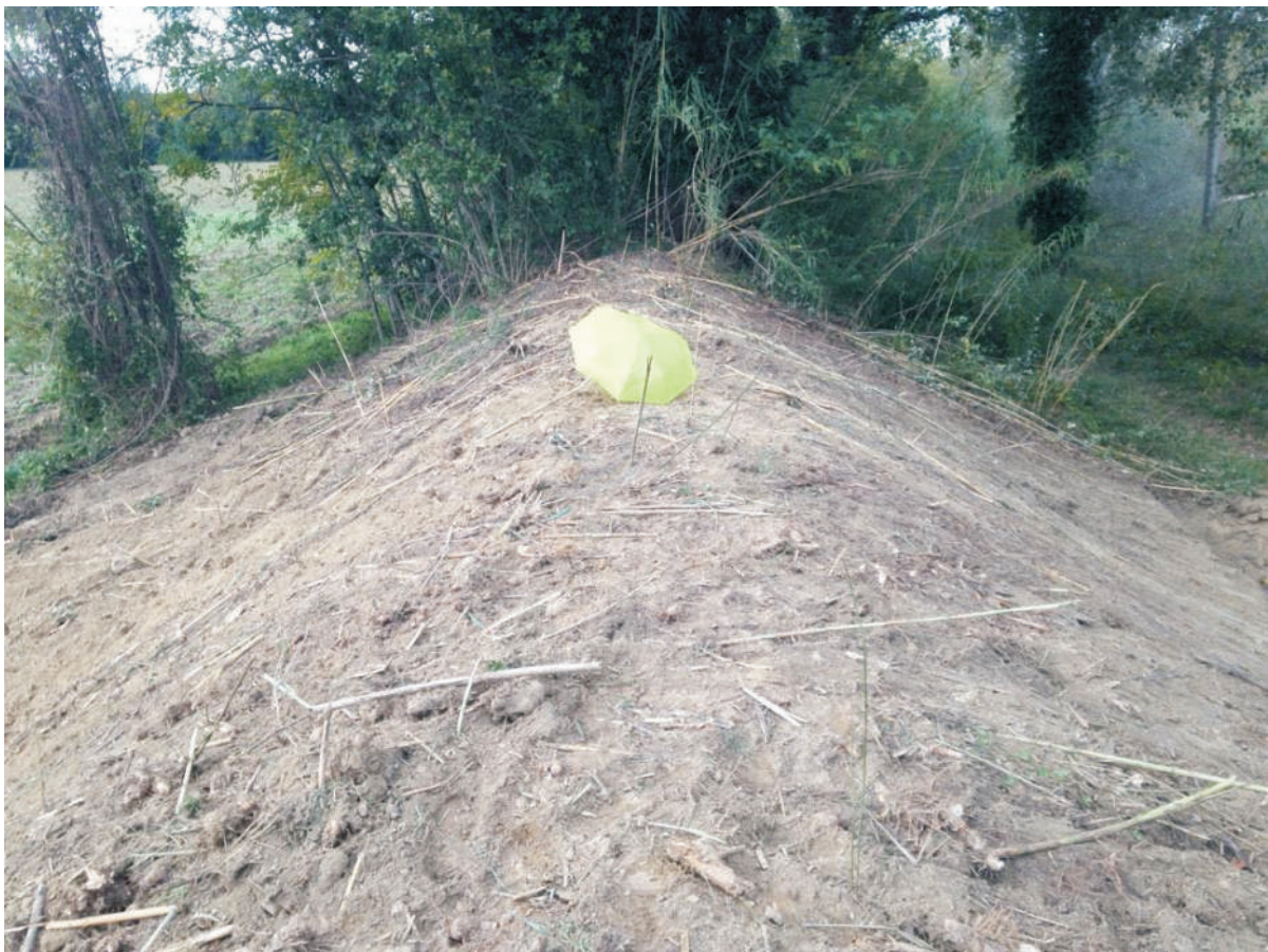
Argine fiume Misa lato Marazzana: Argine “risistemato!” e ricoperto con rete
