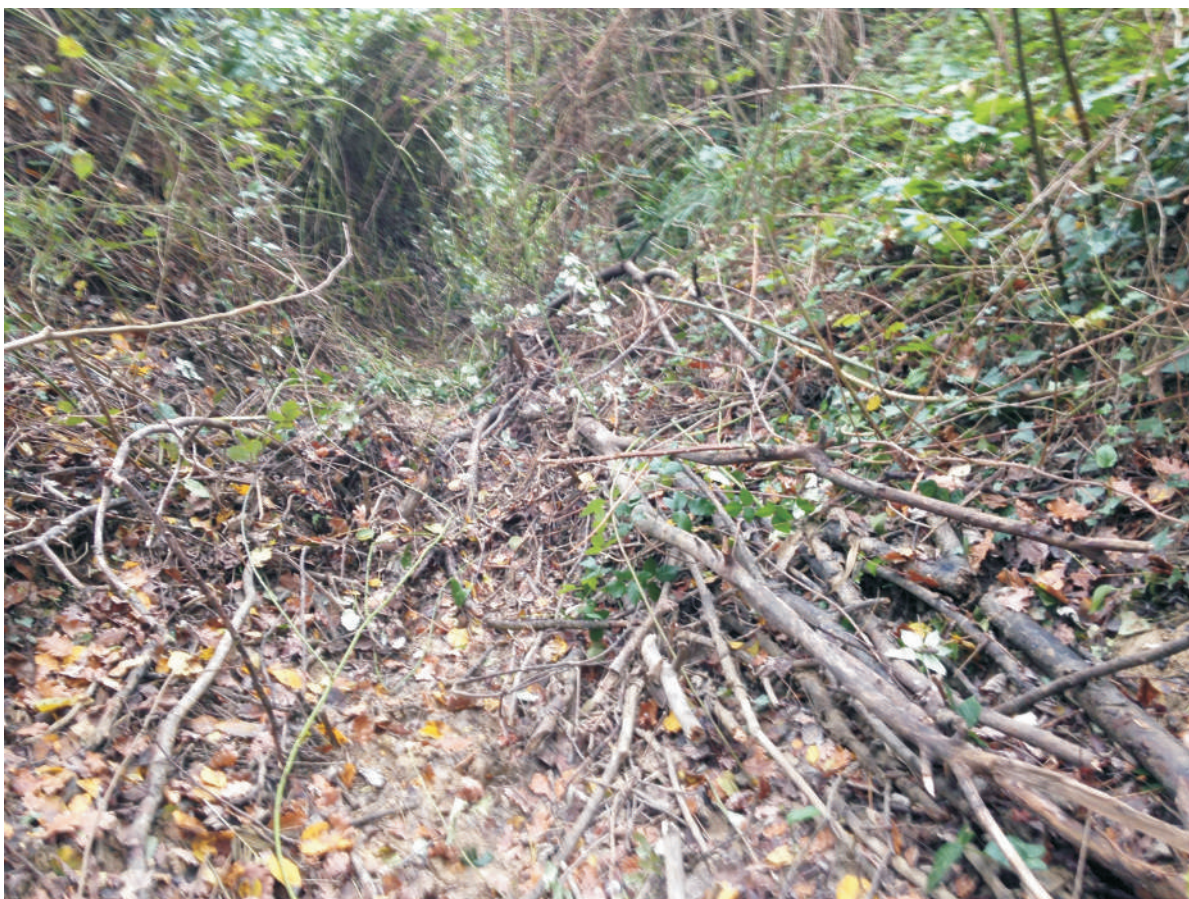
Argine fiume Misa lato Marazzana: Situazione novembre 2019
