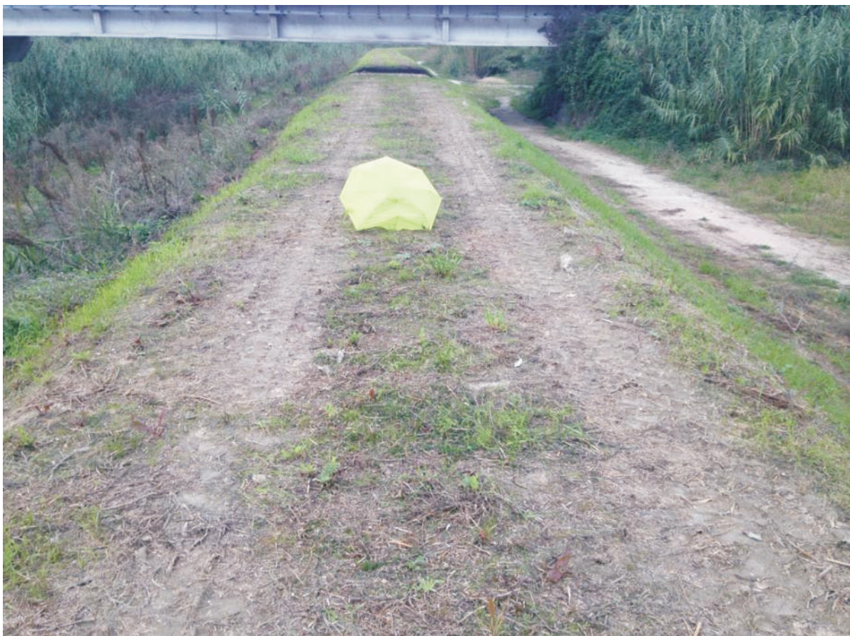
Argine fiume Misa zona Borgo Bicchia Argine totalmente rifatto con sezione notevole ed adeguata
