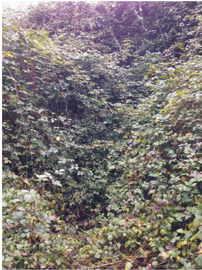
Argine fiume Misa lato Marazzana: Situazione novembre 2019
